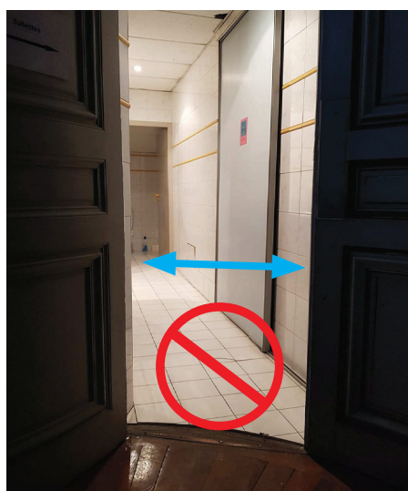
Non conforme : accès aux toilettes impossible
